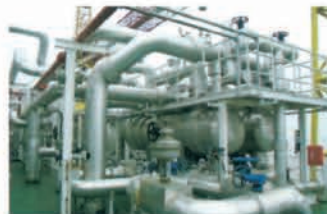
▲ 工业冷热水输送管道
