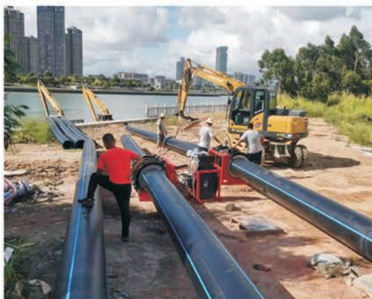
▲ 厦门银鹭食品饮料工程
