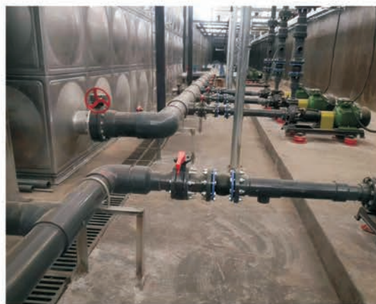
▲ 南亚化工管工程
